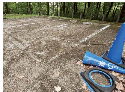
障害者のための国際シンボルマークが消えかかっている皇子が丘公園駐車場
